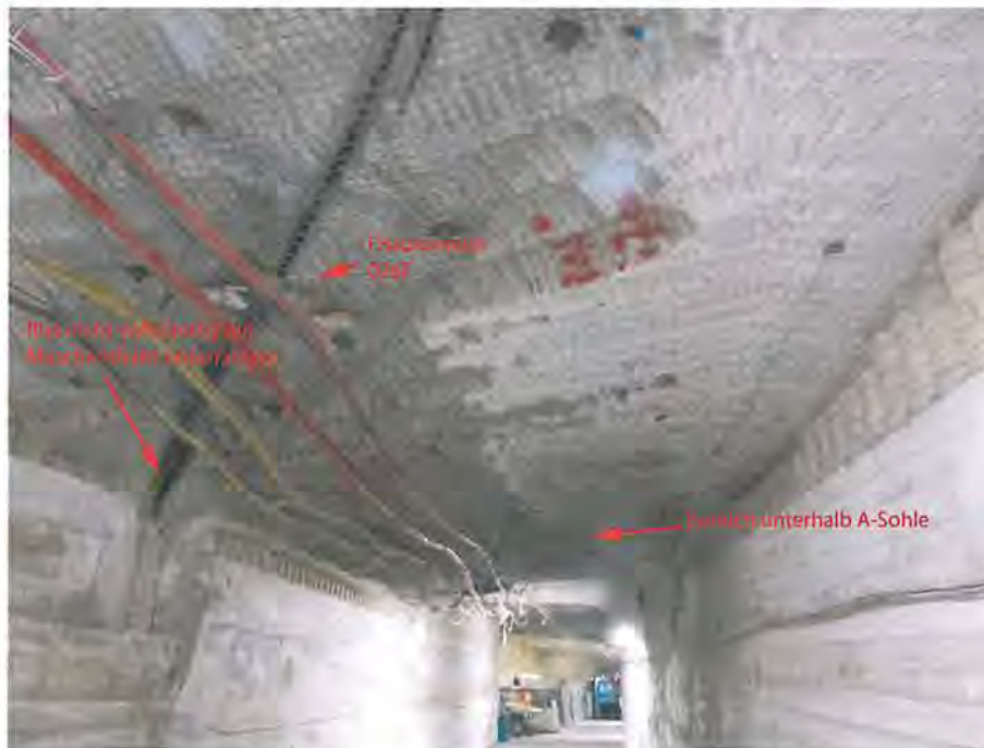
Abbildung 4.60: Zufahrtsbereich mit Stabilisierungsbauwerken an beiden Stößen, unvollständig mit Maschendrahtverzug gesicherten Vertikalrissen sowie Bereich der unterfahrenen A-Sohle, Blick nach Südost (10.03.2020)
