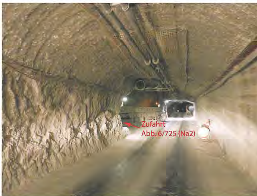
Abbildung 4.20: Östlich des Zugangs von Abbau 6/725 (Na2) intensiv entfestigter Südstoß sowie bis unterhalb des Querschlags zum Hauptgesenk I westl. mit einer Stützmauer sanierter Nordstoß im Wendelstreckenabschnitt von der 700- zur 725-m-Sohle, Blick nach Nordwesten (26.03.2020)
