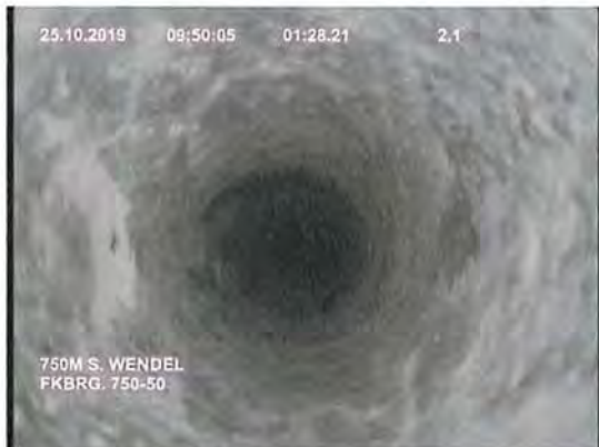
Bild 75: Riss mit Öffnungsweite von ca. 1 bis 2 mm (FKBrG.750-50, Teufe: 1,90 m)
