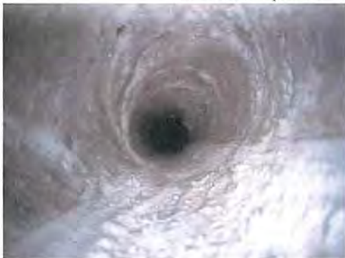
Bild 9: Bohrung 574007; Ausbruch der Bohrwand bei ca. 26 m Bohrlochteufe, Aufnahme vom 10.12.2019
