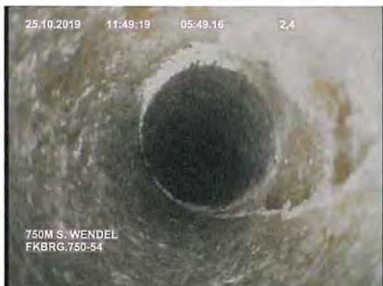
Bild 77: Riss mit geringer Öffnungsweite (FKBrG.750-54, Teufe: 2,40 m)
