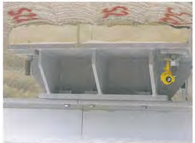
(b) Beispiel eines Kranbahnträgers mit Erhärtungsrisse im Sorelbeton und installiertem Überwachungspunkt, Stand: 29.11.2019
