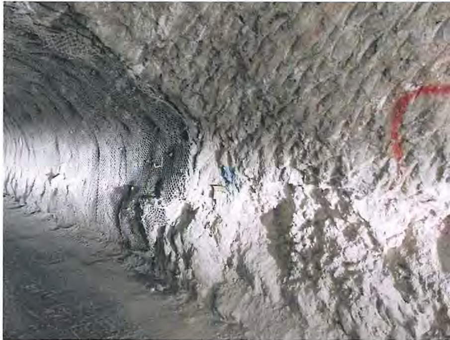
Abbildung 4.36: Intensive Abschalungen am Nordstoß der Richtstrecke nach Osten im Firstniveau auf Höhe der Abbaue 12-13, Blick nach Nordwesten (05.03.2020)
