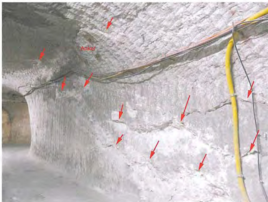
Abbildung 4.59: Bis zum Übergang Stoß/Firste geschädigter Südstoß der nördlichen Richtstrecke nach Westen zwischen westl. Umfahrung und Schacht 4/750 mit geankerter Schale, Blick nach Südwesten (12.02.2019)
