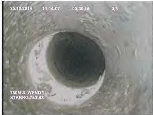
Bild 79: Riss mit Öffnungsweite von ca. 3 bis 4 mm, seitl. versetzt (StKBrg.750-63, Teufe: 0,20 m)
