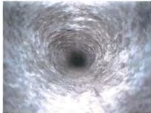
Bild 2: Bohrung 658010; elliptische Bohrlochkontur bei ca. 13 m Bohrlochteufe, Aufnahme vom 12.12.2019
