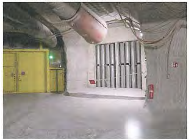
(d) Blick nach Nordosten auf den Hauptgrubenlüfter, Stand: 27.02.2020
