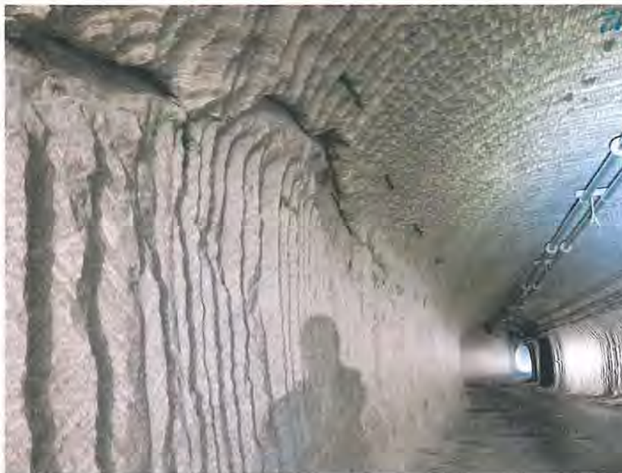
Abbildung 4.22: Bis in den Übergangsbereich zur Firste entfestigter Nordstoß des Wendelstreckenabschnitts von der 725-m- zur 750-m-Sohle, westlich des verfüllten Zugangs zum Füllort Schacht 4/750, Blick nach Nordosten (21.02.2020)
