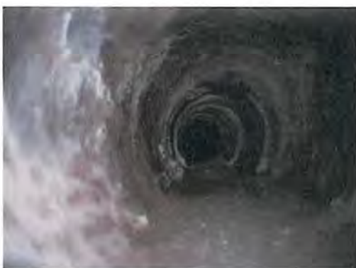
Bild 5: Bohrung 679006; Lauge auf der Sohle bei ca. 1 m Bohrlochteufe, Aufnahme vom 17.12.2019
