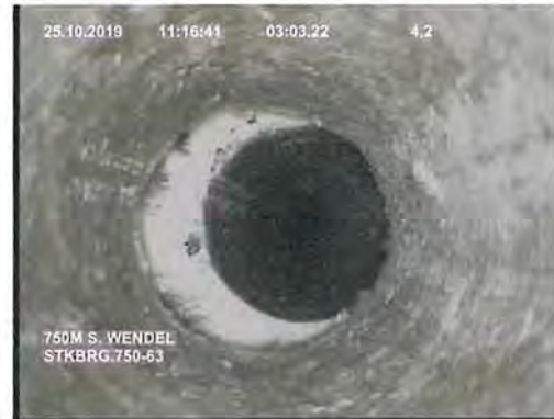
Bild 80: Riss mit Öffnungsweite von ca. 6 bis 7 mm, seitl. versetzt (StKBrg.750-63, Teufe: 4,20 m)
