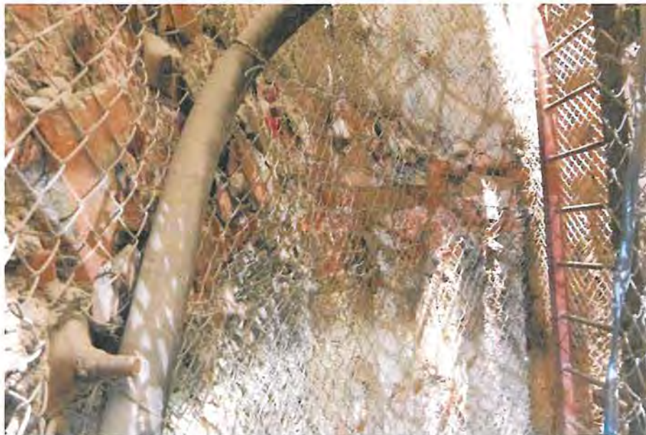
Abbildung 4.53: Intensiv geschädigter Schachtausbau mit Rissen in Beton und Mauerwerk unterhalb der Füllortbühne, Blick nach Westen (10.03.2020)
