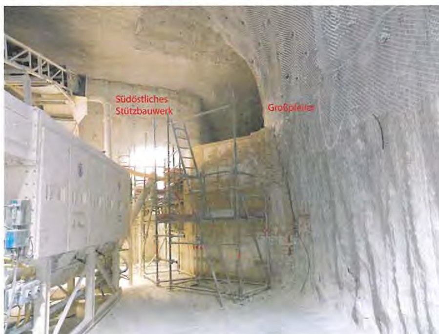
Abbildung 4.27: Erstellung eines Stützbauwerks im Bereich des Förderbands zwischen Großpfeiler und Südstoß mit Anbindung an das firstbündige Stützbauwerk am südöstlichen Stoß der 20BA, Blick nach Südwesten (21.02.2020)
