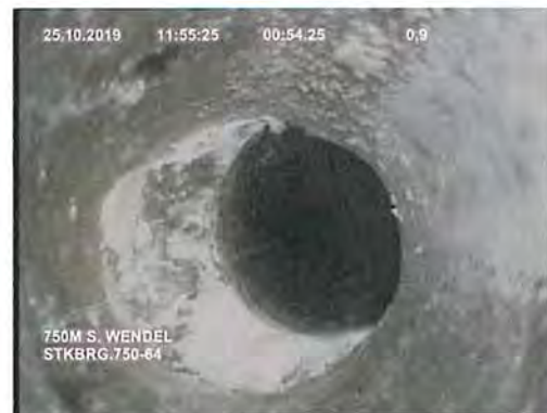
Bild 82: Riss mit Öffnungsweite von ca. 6 bis 7 mm, seitl. versetzt (StKBrg.750-64, Teufe: 0,90 m)
