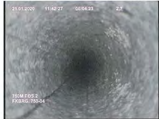
Bild 88: Beginnende Ausblühungen in leicht feuchter Bohrlochkontur (FKBrg.750-04, Teufe: 2,70 m)
