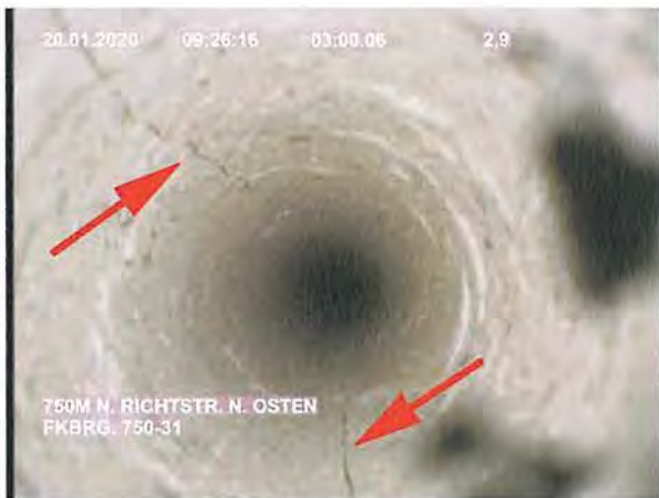
Bild 95: FKBrG. 750-31 – Position bei ca. 2,9 m vertikale Haarrisse im Sorelbeton
