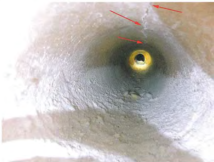
Abbildung 4.35: Riss von geringer Öffnungsweite in der hangenden Bohrungskontur von VorEBrg. 700-1a.1, Blick nach Osten (05.03.2020)
