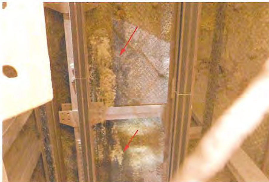
Abbildung 4.55: Eintrocknete stalaktitenförmige Verlaufspuren von Lösung am Nordweststoß zwischen Füllort- und Buchholzbühne, Blick nach Norwesten (10.03.2020)
