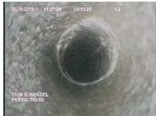
Bild 76: Riss mit Öffnungsweite von ca. 1 bis 2 mm (FKBrG.750-53, Teufe: 1,30 m)
