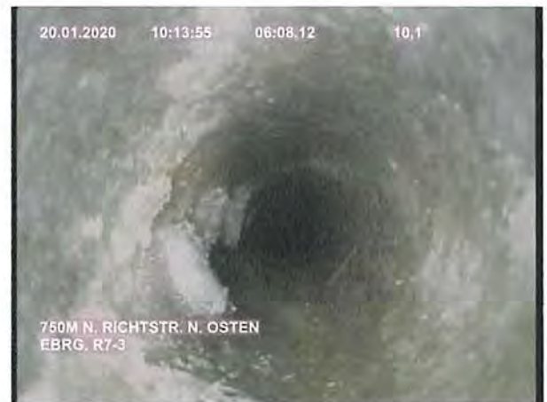
Bild 100: EBrG. R7.3 – Position bei ca. 9,9 m Salzausblühungen an potentieller Auflocke- rung
