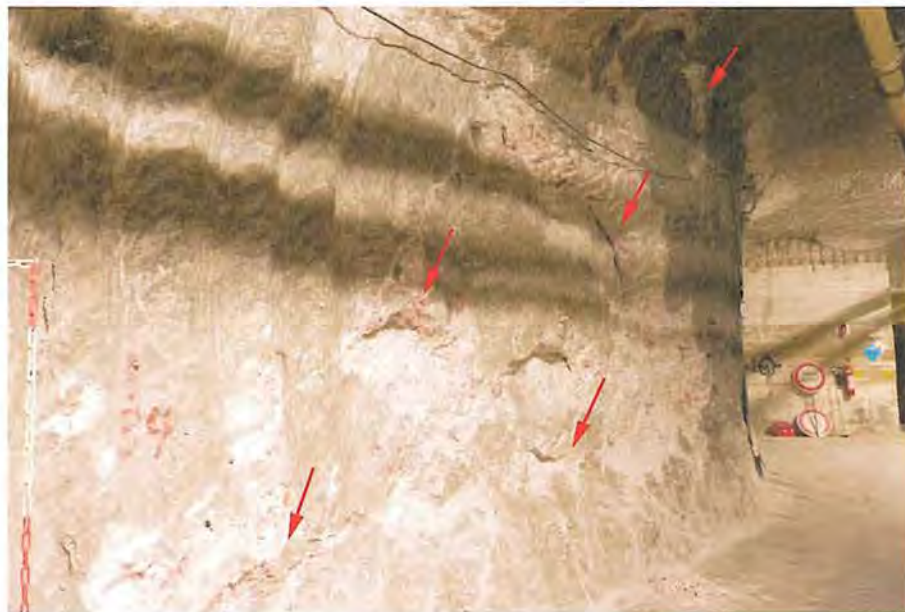
Abbildung 4.58: Regelmäßig beraubter intensiv geschädigter Norddstoß der nördlichen Richtstrecke nach Westen zwischen westl. Umfahrung und Schacht 4/750, Blick nach Südwesten (12.02.2019)
