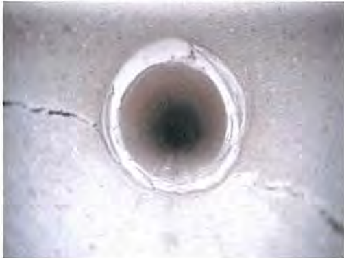
Bild 7: Bohrung 553014; Risse in der Bohrwand und Ausbruch bei ca. 44 m Bohrlochteufe, Aufnahme vom 09.12.2019
