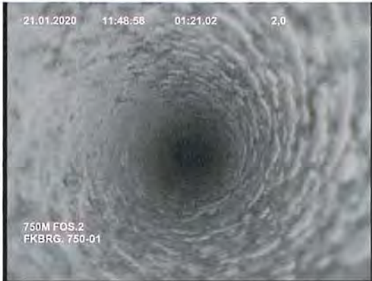
Bild 87: Spure des Bohrvorgangs und anhaftendes Bohrmehl (FKBrg.750-01, Teufe: 2,00 m)
