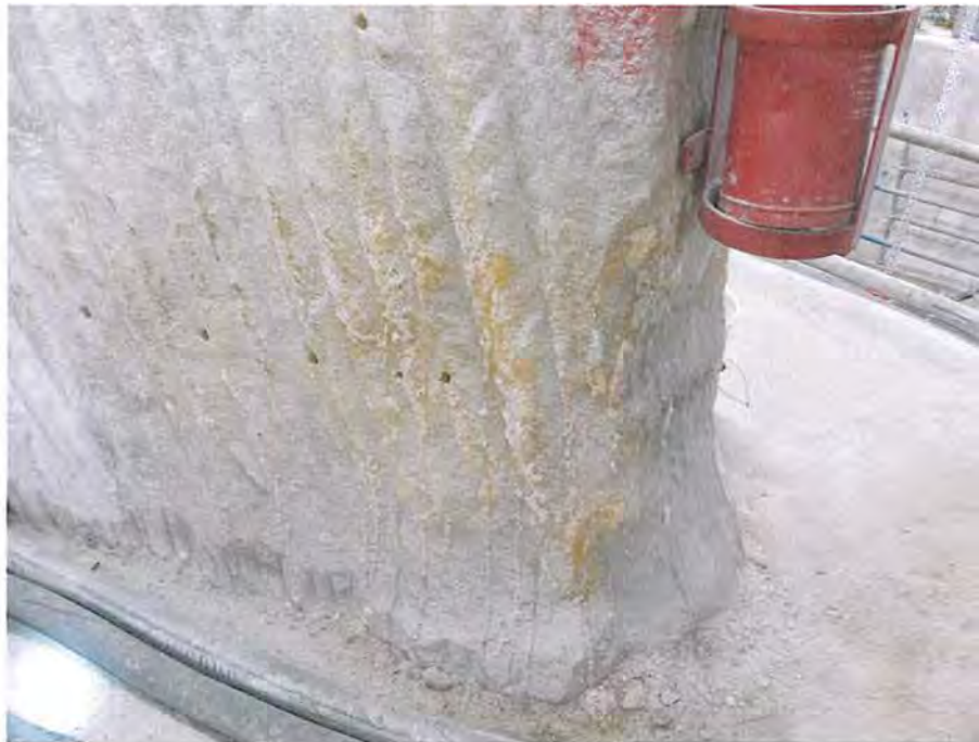
Abbildung 4.34: Feuchtestelle mit Verlaufspuren von Lösung im Pfeiler zwischen den beiden Teilbohr- örtern - unterhalb VorEBrg. 700-1a.1, Blick nach Südosten (05.03.2020)
