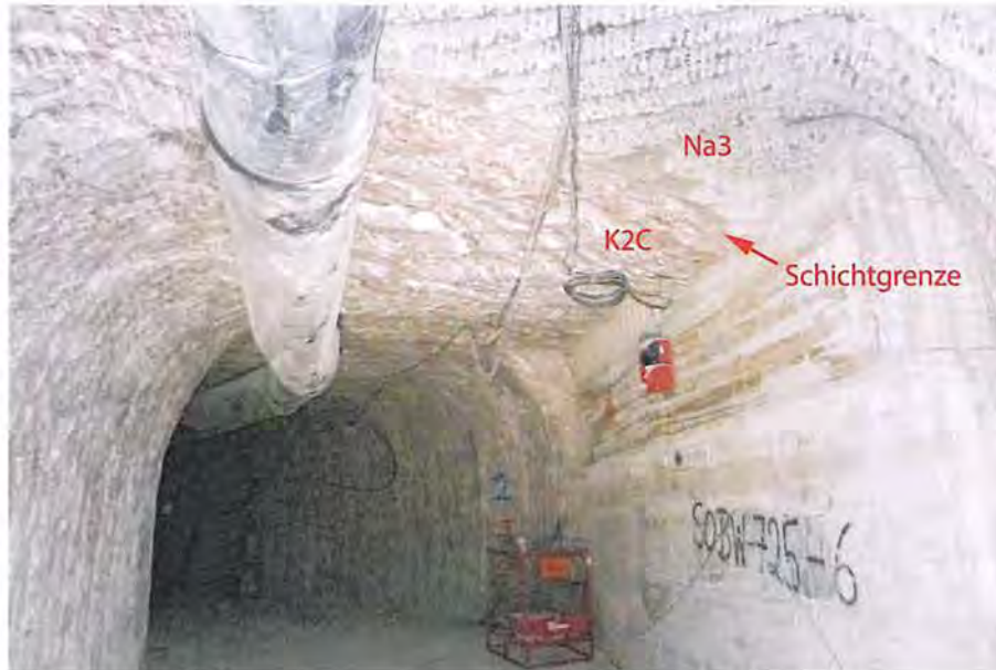
Abbildung 4.47: Geankerte Schichtgrenze Na3 \beta /K2C und verfüllter Zugang zu Abbau 4/725 im südlichen Abschnitt des Querschlags nach Norden, Blick nach Nordosten, 02.03.2019
