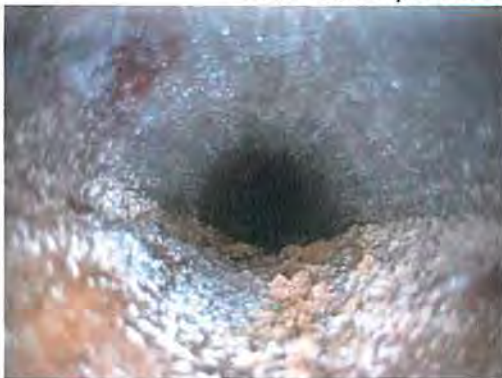
Bild 3: Bohrung 553012; Dunkelfärbung der Bohrlochsohle und Ausblühungen bei ca. 0,5 m Bohrlochteufe deuten auf Feuchtigkeit hin, Aufnahme vom 09.12.2019
