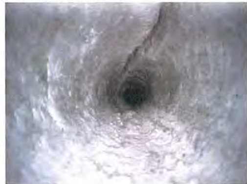
Bild 12: Bohrung 595006; Riss bei ca. 29 m, Aufnahme vom 11.12.2019
