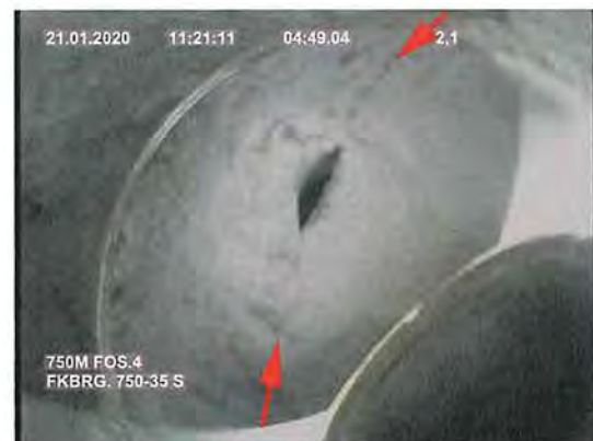
Bild 92: Beginnende Rissöffnung (FKBrg.750-35, Teufe: 2,20 m)
