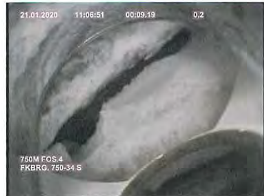
Bild 90: Geöffneter Riss, Öffnungsweite bis ca. 3 mm (FKBrg.750-34, Teufe: 0,10 m)
