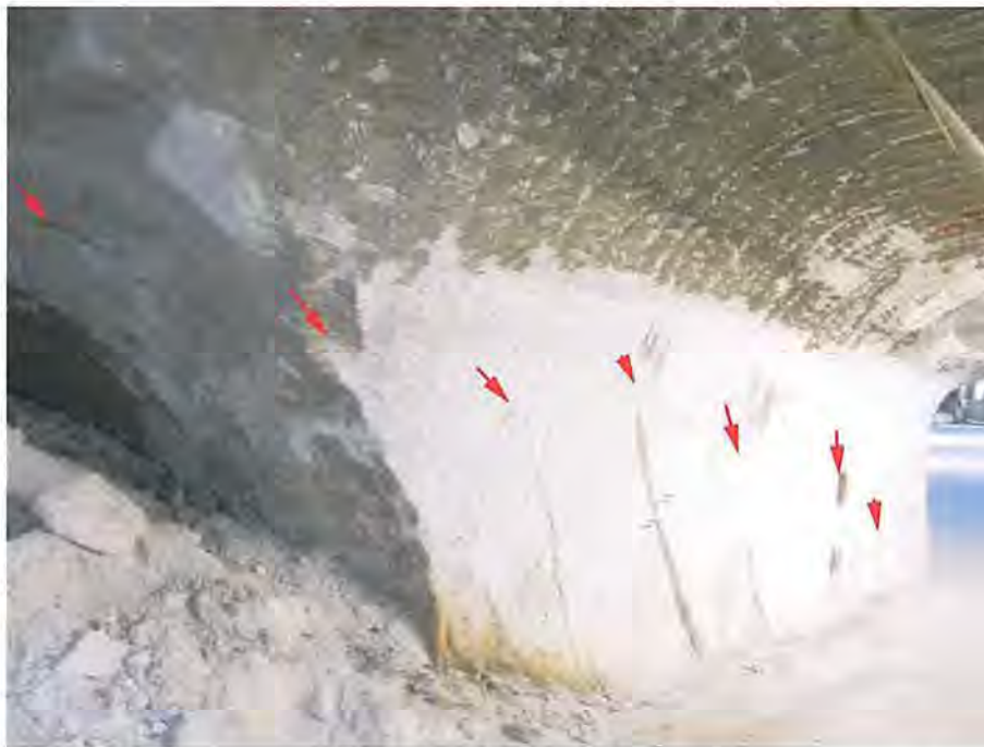
Abbildung 4.63: Entfestigter Pfeiler mit Vertikalrissen am Nordstoß zwischen den Abbauen 5 und 4/750 (Na2). Der Abbau 4/750 (Na2) ist im Übergang nicht firstbündig verfüllt und weist zumindest am Nordstoß Hohlräume unbekannter Ausdehnung auf, Blick nach Osten (10.03.2020)
