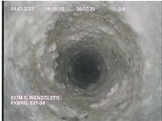
Bild 73: durch Salzausblühungen verengte Bohrlochkontur (FKBrG.637-34, Teufe: 2,40 m)
