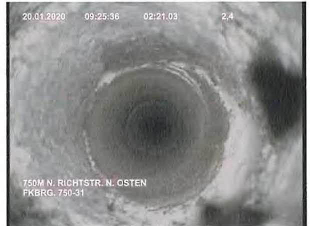
Bild 94: FKBrG. 750-31 – Position bei ca. 2,45 m unvollständig. Verbund Salz / Sorelbeton
