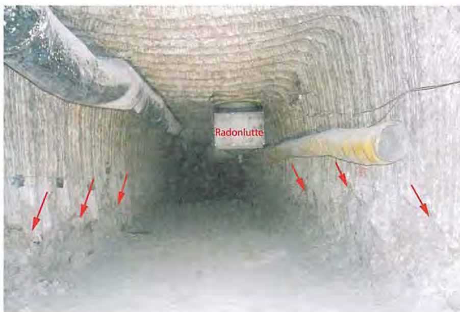
Abbildung 4.48: Nördlicher Abschnitt des Querschlags nach Norden mit der zur Fluchtbohrung verlaufenden Radonlutte und geschädigtem Weststoß, Blick nach Norden, 02.03.2019
