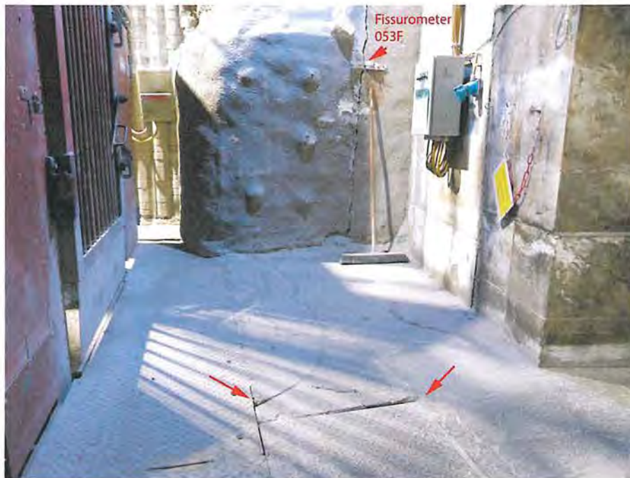
Abbildung 4.50: Füllortbereich westlich des Schachts 2 mit zunehmender Aufwölbung bzw. Schädigung der Sohle. Ein Riss in der nicht firstbündigen Spritzbetonstabilisierung des südöstlichen Pfeilers wird durch Fissurometer 053F überwacht, Blick nach Südwesten (21.02.2020)
