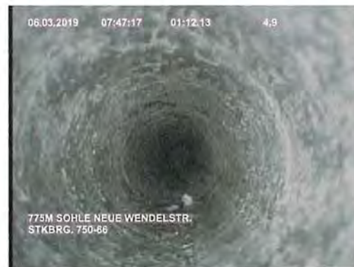
Bild 84: Salzausblühungen in feuchter Kontur (StKBrg.750-66, Teufe: 4,90 m)
