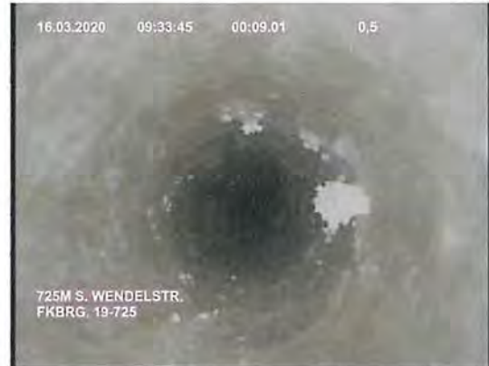
Bild 74: Salzausblühungen in feuchter Kontur (FKBrG.725-19, Teufe: 0,50 m)
