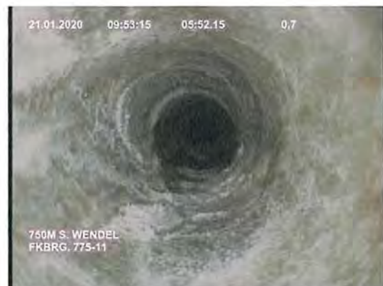
Bild 78: Ausblühungen an beanspruchter Kontur (FKBrG.775-11, Teufe: 0,70 m)
