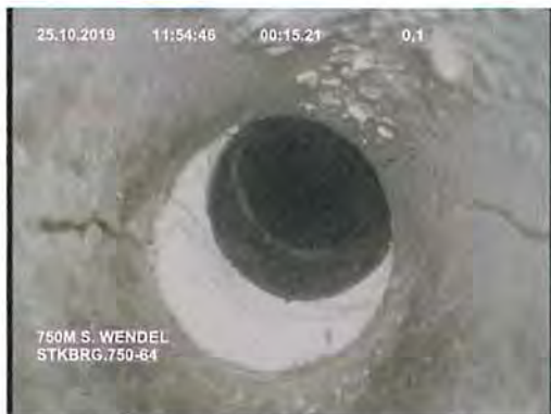
Bild 81: Riss mit Öffnungsweite von ca. 2 bis 4 mm, seitl. versetzt (StKBrg.750-64, Teufe: 0,10 m)
