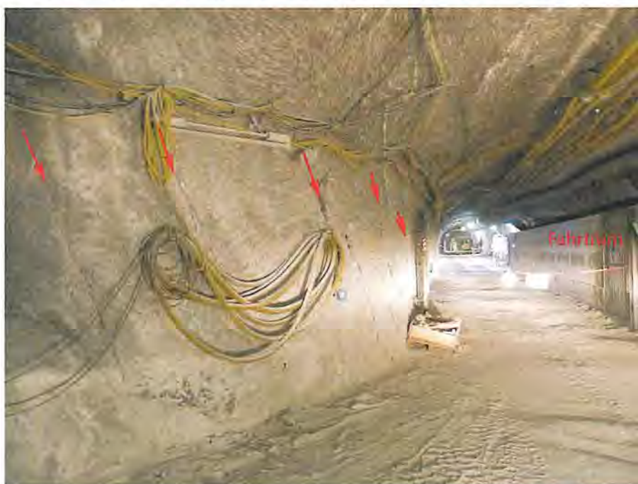
Abbildung 4.32: Vahlberger Strecke mit entfestigtem Südstoß unmittelbar westlich der Einmündung des Querschlags zum Blindschacht 3 sowie abgetrenntem Fahrtrum am Nordstoß, Blick nach Westen (05.03.2020)
