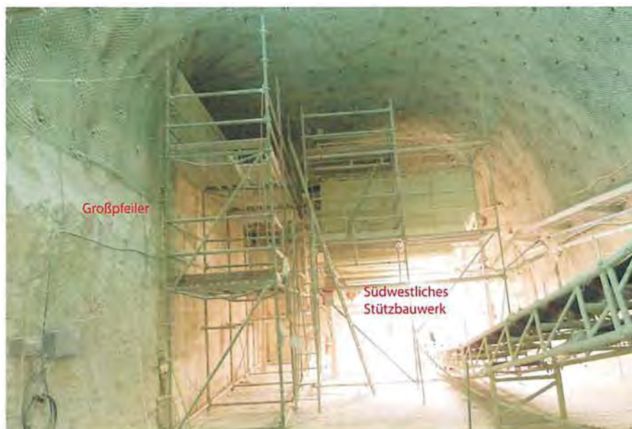
Abbildung 4.26: In Erstellung befindliches Stützbauwerk im Bereich des Förderbands zwischen Großpfeiler und Südstoß mit Anbindung an das firstbündige Stützbauwerk am südwestlichen Stoß der 20BA, Blick nach Süden (21.02.2020)
