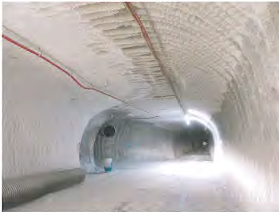
Abbildung 4.24: Aufweitung und teilweiser Nachschnitt der Wendelstreckenkontur im Bereich der 825-m-Sohle an der Zufahrt zur Unterfahrung der HAW-Versuchsfelder, Blick nach Osten (26.03.2020)
