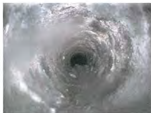
Bild 6: Bohrung 679006; Ausbruch in der Firste und feuchtes Haufwerk in der Sohle bei ca. 4 m Bohrlochteufe, Aufnahme vom 17.12.2019
