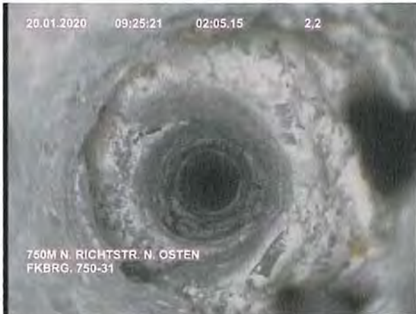
Bild 93: FKBrG. 750-31 – Position bei ca. 2,24 m Öffnungsweite ca. 4 mm
