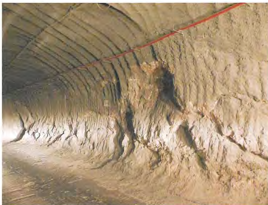
Abbildung 4.16: Signifikant entfestigter Nordstoß der Wendelstrecke auf Höhe zwischen Abbau 7 und Abbau 8 auf der 595-m-Sohle, Blick nach Westen (21.02.2020)
