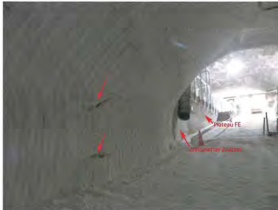
Abbildung 4.67: Beim Nachschnitt des entfestigten Südstoßes im Zufahrtbereich zum Abbau 5/750 (Na2) wurden die Schädigungen bis auf reliktsiche Risse weitgehend entfernt. Der geschädigte Zwickel im Übergang des Südstoßes zum Sorelbetonplateau des Standorts der Faktenerhebung wurde betoniert. Blick nach Südwesten (10.03.2020)
