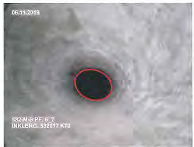
(b) Deformation des Bohrloches bei einer Bohrlochteufe von ca. 33 m
