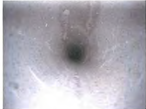
Bild 8: Bohrung 637013; Ausblühungen deuten auf Feuchtigkeit bei ca. 39 m Bohrlochteufe, Aufnahme vom 18.12.2018
