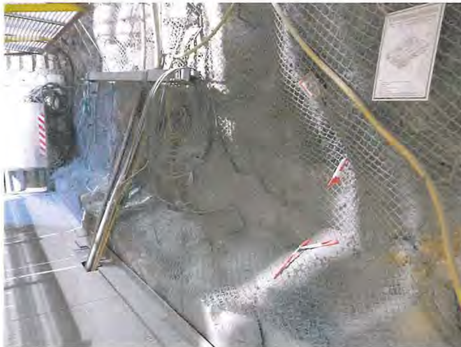
Abbildung 4.52: Intensiv entfestigter südlicher Stoß des nördlichen Füllortpfeilers von Schacht 2/750 mit Rissen und Abschalungen, Blick nach Nordwesten (10.03.2020)
