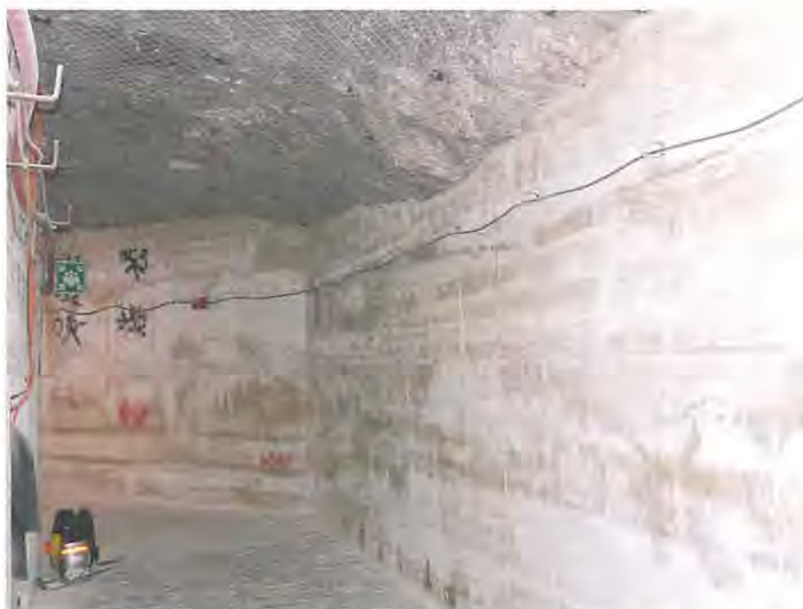
Abbildung 4.57: Durch Stützbauwerke stabilisierter Zugang zum Füllort Schacht 4/750 mit Systemankerung an entfestigter Firste und neu verlegtem Verbundsteinpflaster in der Sohle (21.02.2020)
