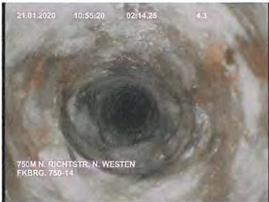
Bild 89: Salzausblühungen in feuchter Bohrlochkontur (FKBrg.750-14, Teufe: 4,30 m)
