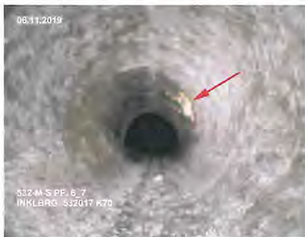
(a) Feuchtigkeit in Form von Ausblühungen bei ca. 10 m Bohrlochteufe
