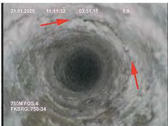
Bild 91: Beginnende Rissöffnung (FKBrg.750-34, Teufe: 0,90 m)
