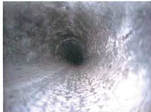
Bild 10: Bohrung 700005; Ausbruch in der westlichen Bohrwand bei ca. 34 m Bohrlochteufe, Aufnahme vom 16.12.2018
