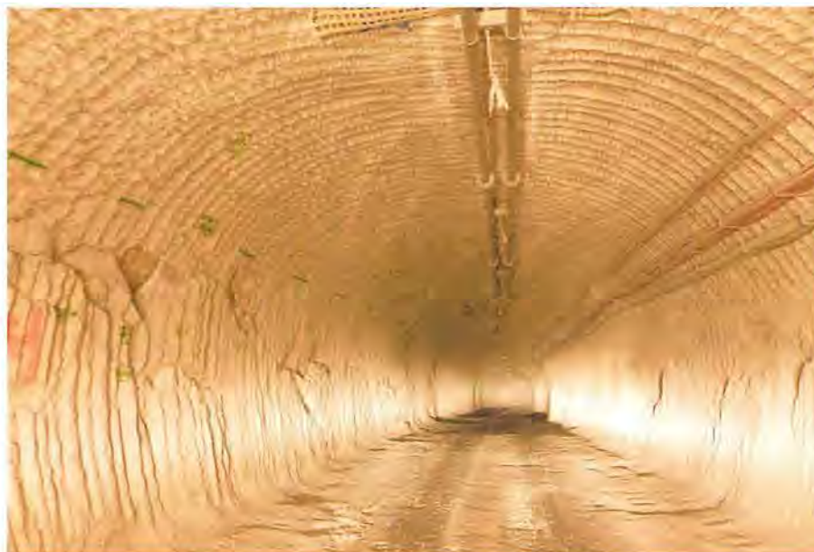
Abbildung 4.21: Östlicher Wendelstreckenabschnitt von der 725-m- zur 750-m-Sohle mit starken, bis in den Übergang zur Firste reichenden Abschalungen am Nord- und Südstoß , Blick nach Südosten (21.03.2019)
