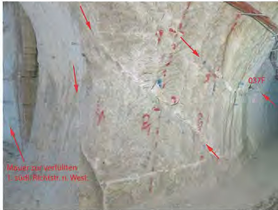
Abbildung 4.23: Nachgeschnittene Pfeilerspitze am Südstoß im Ostteil der Wendelstreckenumfahrung zur 775-m-Sohle mit Fissurometer 037F an steil einfallenden Trennflächen sowie Schalungswände zur Verfüllung der 1. südlichen Richtstrecke nach Westen, Blick nach Südwesten (21.02.2020)
