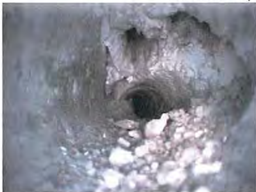
Bild 11: Bohrung 595006; Riss und Konturausbrüche sowie Haufwerk bei ca. 27 m Bohrlochteufe, Aufnahme vom 11.12.2019
