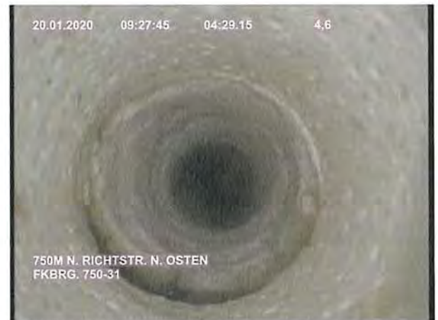
Bild 96: FKBrG. 750-31 – Position bei ca. 4,60 m Firstspalt, Öffnungsweite ca. 8 mm
