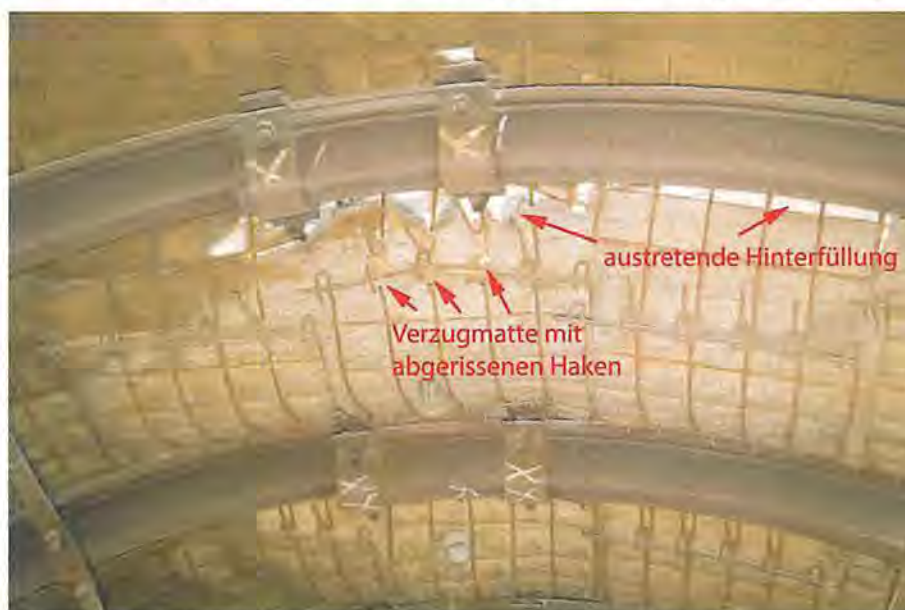
Abbildung 4.38: Schädigungen der Verzugmatten mit einhergehendem Austritt von Hinterfüllungsmaterial im Firstbereich der Gleitbögen 16 und 17 im Abbau 1/725, Blick nach Osten, 02.03.2020
