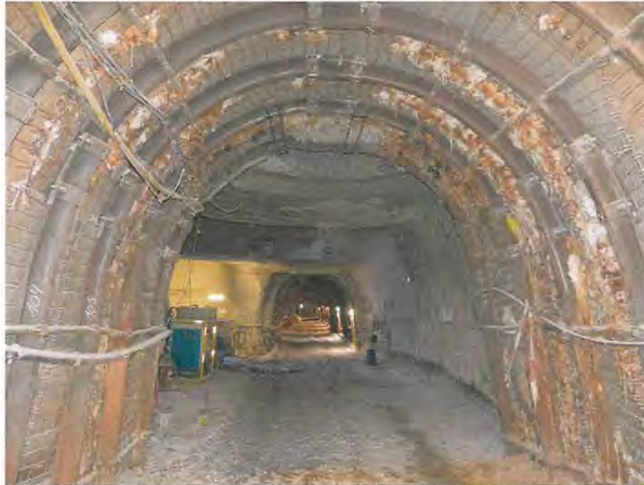
Abbildung 4.39: Gleitbogenausbau in Abbau 2 mit stalaktitenförmigen Salzausfällungen sowie Kristallisat auf der Schottersohle im östlichen Randbereich, Blick nach Osten, 02.03.2020
