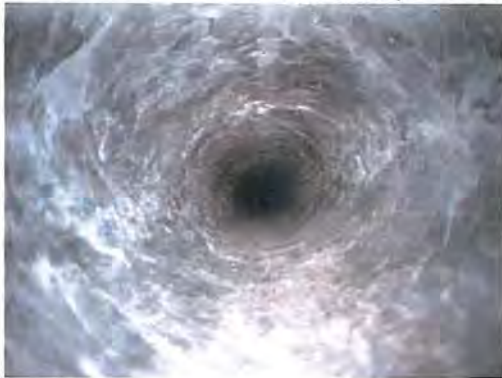
Bild 1: Bohrung 532015; elliptische Bohrlochkontur und kleinere Ausbrüche bei ca. 41 m Bohrlochteufe, Aufnahme vom 13.12.2019
